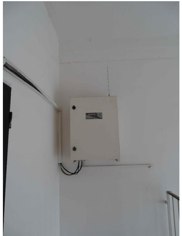
ES.8 – umístění rozvaděče stávající sirény v prostoru střešní nástavby schodiště
