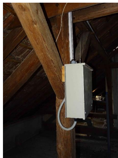
ESN.12 – stávající stožár sirény – uchycení rozvaděče
