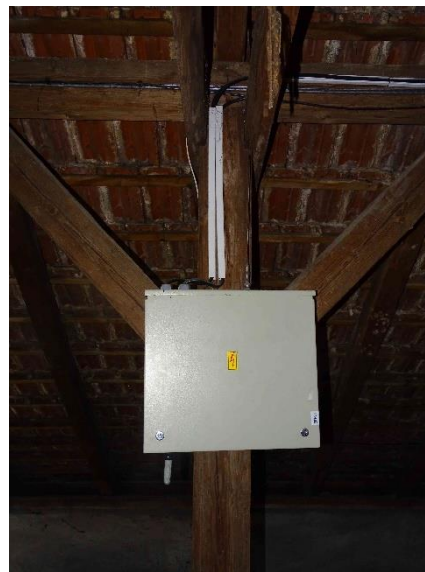
ESN.12 – umístění rozvaděče stávající sirény, v půdním prostoru
