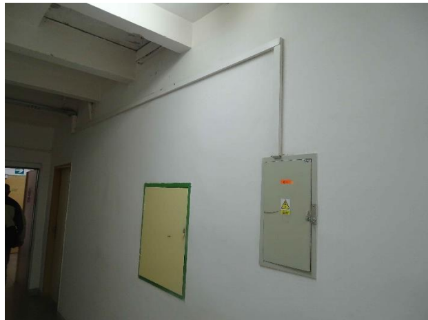
EST.3 – umístění stávajícího rozvaděče NN na chodbě 4.NP.
