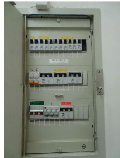
EST.3 – stávající NN rozvaděč
