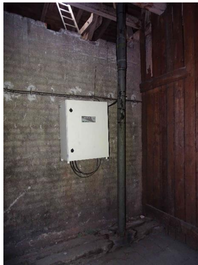
ESH.7 – umístění rozvaděče stávající sirény
