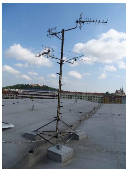
EST.15 – stávající stožár bude vyměněn
