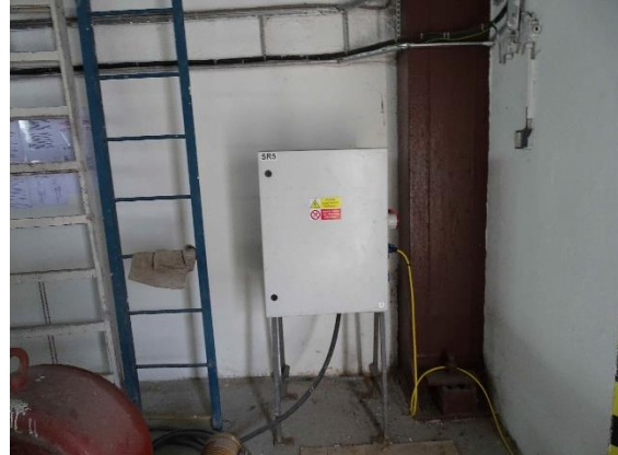
EST.11 – umístění stávajícího rozvaděče NN
