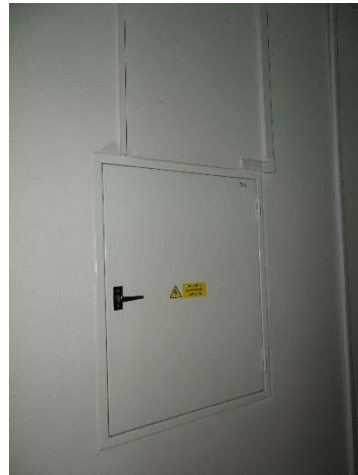
EST.6 – umístění stávajícího rozvaděče NN v chodbě 4.NP
