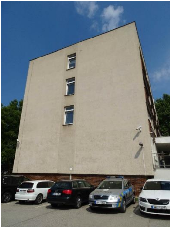
EST.6 – boční stěna kde bude uchycen nový stožár sirény (podél okna chodby ve 4.NP)
