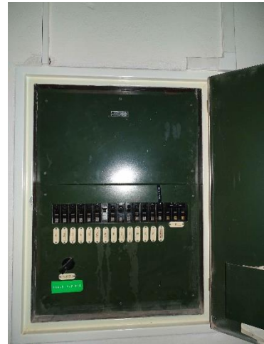
EST.6 – rozvaděč 4.NP bude doplněn o 1f jistič B10 a podružné měření
