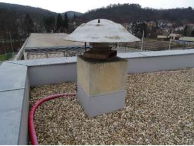
ESN.5 – stávající siréna na střeše Pisárecká 555/1a
