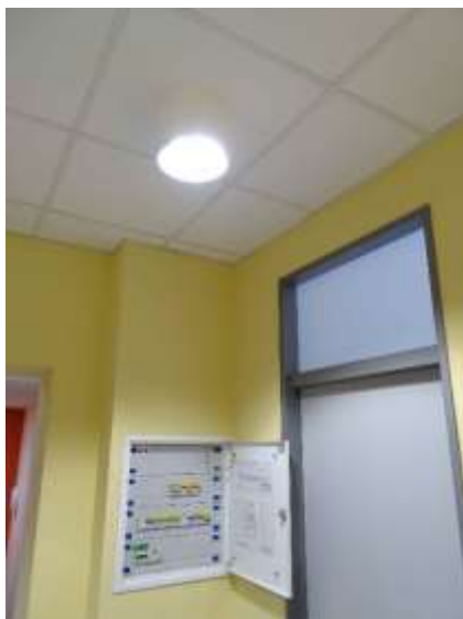
ESN.5 – stávající rozvaděč pro nový přívod sirény (bude doplněn o nový jistič a podružné měření)
