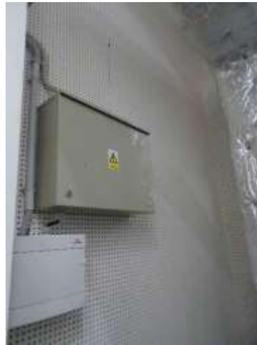
ESN.5 – umístění rozvaděče stávající sirény, ve strojovně VZT
