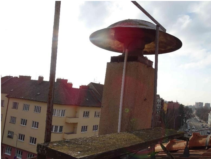
ESN.20 – stávající siréna, pro novou elektronickou sirénu je nevyhovující kotvení na sloupku
