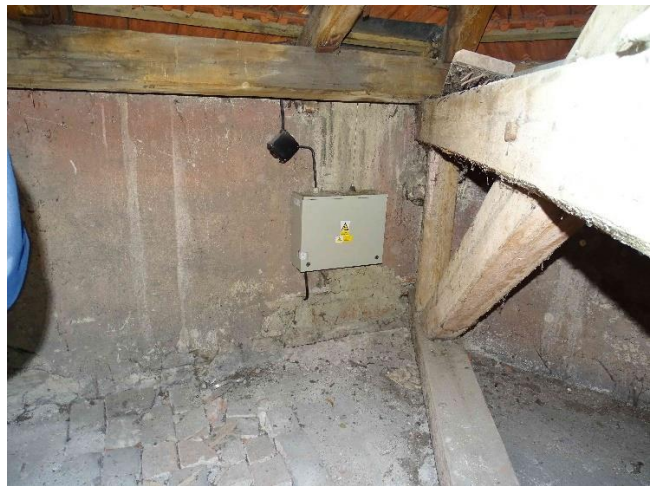
ESN.20 – umístění rozvaděče stávající sirény, podkrovním prostorem
