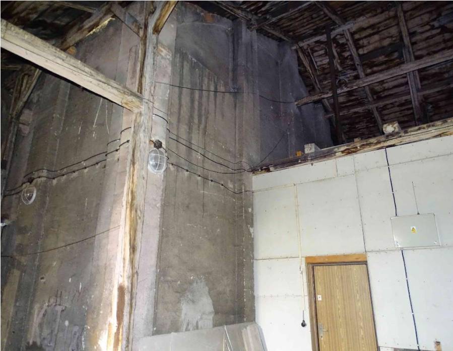
ESN.17 – stávající stožár sirény – uchycení na trámy v půdní nadstavbě nad schodištěm
