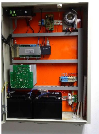
ESH.5 – stávající rozvaděč sirény
