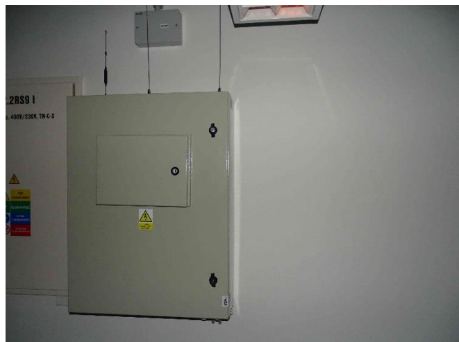
ESH.5 – umístění rozvaděče stávající sirény, na chodbě
