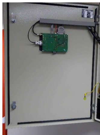
ESH.5 – stávající rozvaděč sirény
