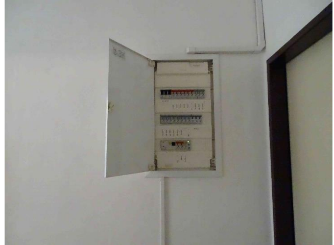
ESN.16 – stávající rozvaděč napájení
