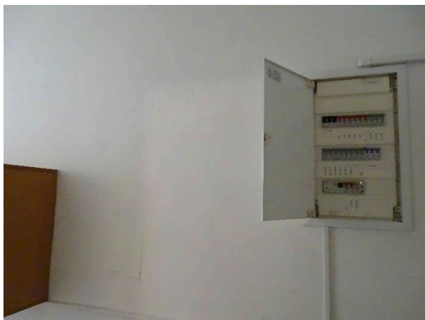
ESN.16 – místo pro nový rozvaděč sirény OS (vedle rozvaděče napájení)
