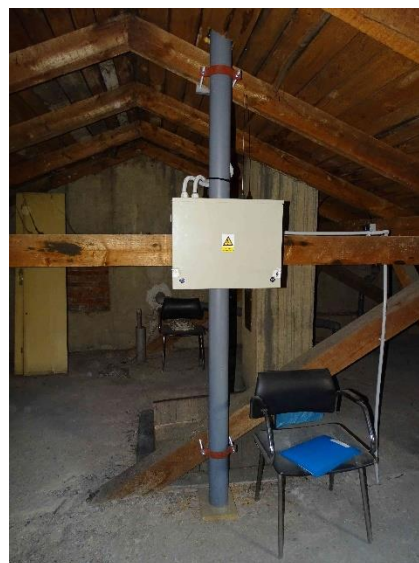
ESN.16 – umístění rozvaděče stávající sirény, v podkrovním prostoru
