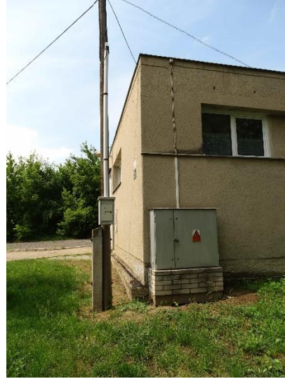
EST.16 – umístění stávajícího rozvaděče NN
