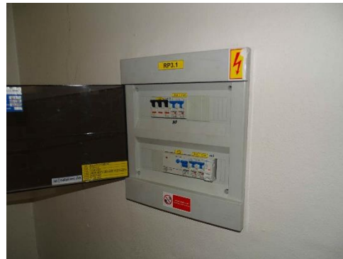
EST.13 – umístění stávajícího rozvaděče NN
