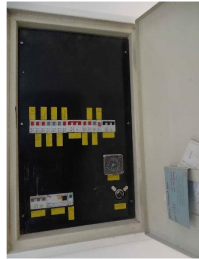
EST.19 – objekt ÚMČ, stávající patrový rozvaděč bude doplněn o nový vývod 1f B10
