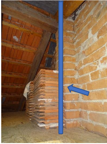
EST.19 – objekt ÚMČ, místo pro nový stožár
