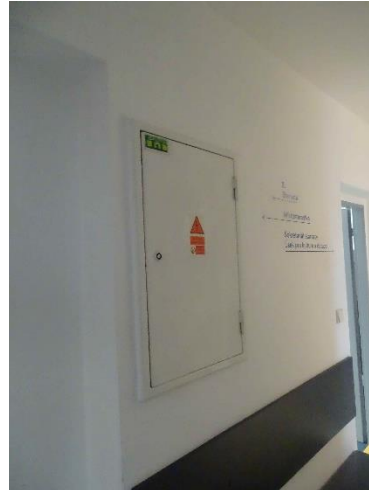
EST.19 – umístění stávajícího rozvaděče NN
