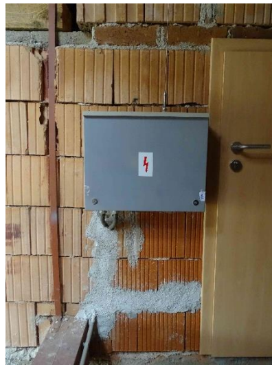
ESN.15 – umístění rozvaděče stávající sirény, v podkrovním prostoru
