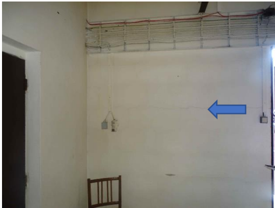
EST.18 – místo pro nový rozvaděč sirény
