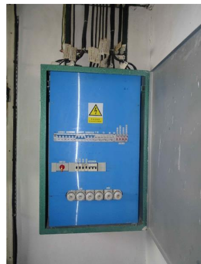
EST.18 – stávající rozvaděč NN bude o podružné měření a 1f jistič B10
