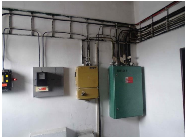
EST.18 – umístění stávajícího rozvaděče NN v technické místnosti.
