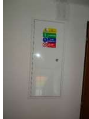
EST.7 – umístění stávajícího rozvaděče NN
