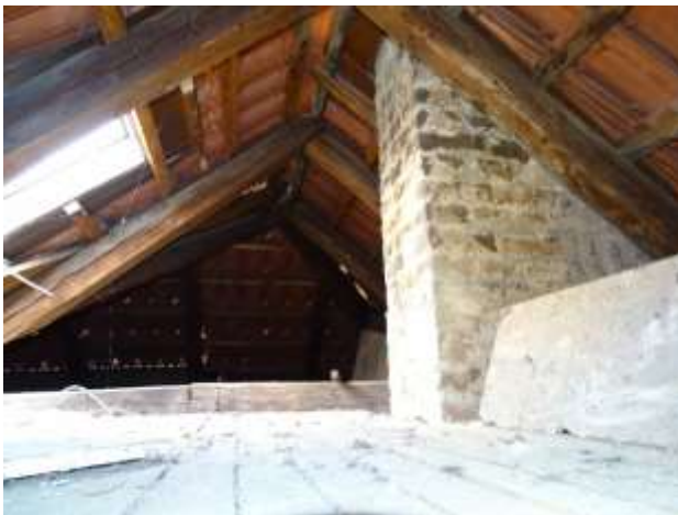
EST.7 – objekt ÚMČ Brno-jih, místo pro rozvaděč sirény
