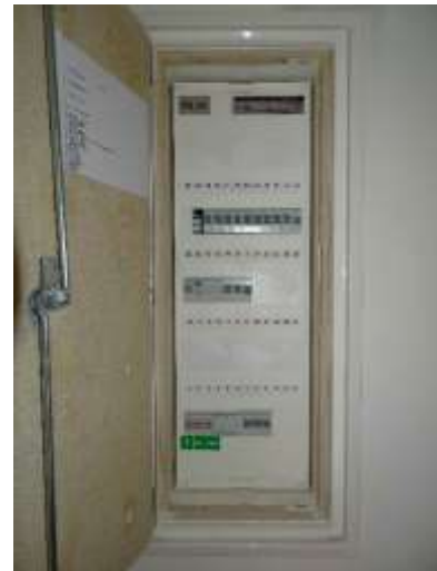
EST.7 – objekt ÚMČ Brno-jih, stávající patrový rozvaděč bude doplněn o nový vývod 1f B10
