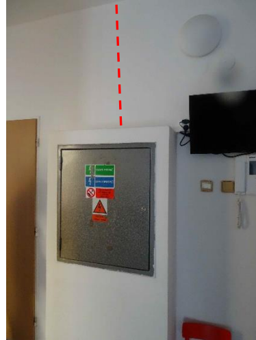
EST.9 – umístění stávajícího rozvaděče NN na chodbě ve 3.NP
