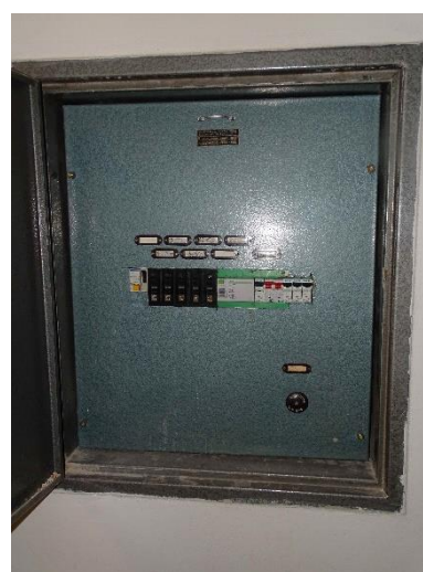
EST.9 – stávající patrový rozvaděč bude doplněn o nový vývod 1f B10 a podružné měření
