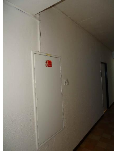
EST.20 – umístění stávajícího rozvaděče NN v chodbě 2.NP
