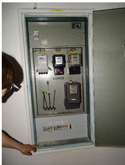
EST.20 – rozvaděč NN
