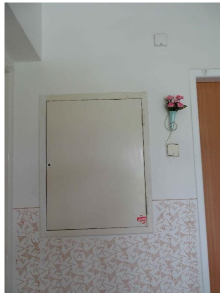
EST.8 – umístění stávajícího rozvaděče NN v chodbě 2.NP
