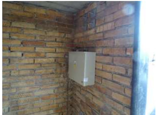
ESN.11 – umístění rozvaděče stávající sirény, v technické nástavbě střechy
