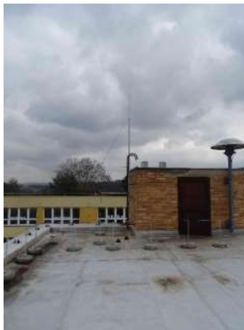
ESN.11 – stávající stožár sirény – hromosvod s jímačem
