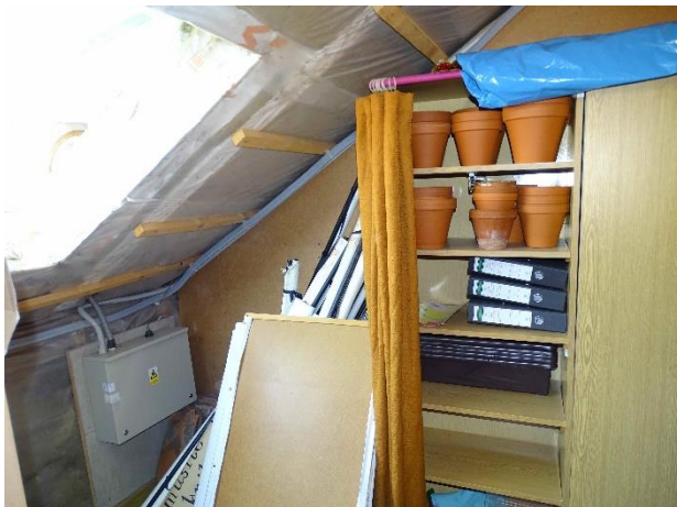
EST.4 – umístění stávajícího rozvaděče sirény
