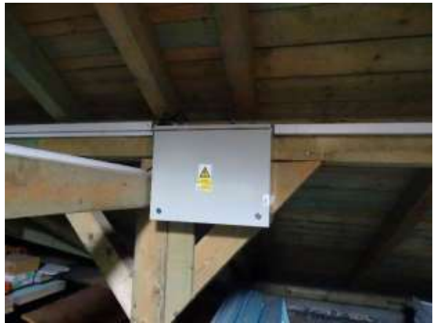
ESN.13 – umístění rozvaděče stávající sirény, v půdním prostoru
