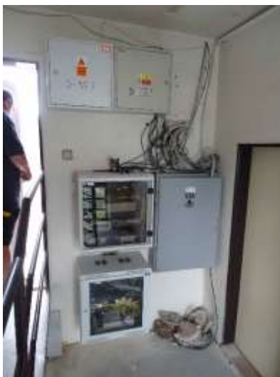
EST.2 – průchod stávajících kabelů na střechu
