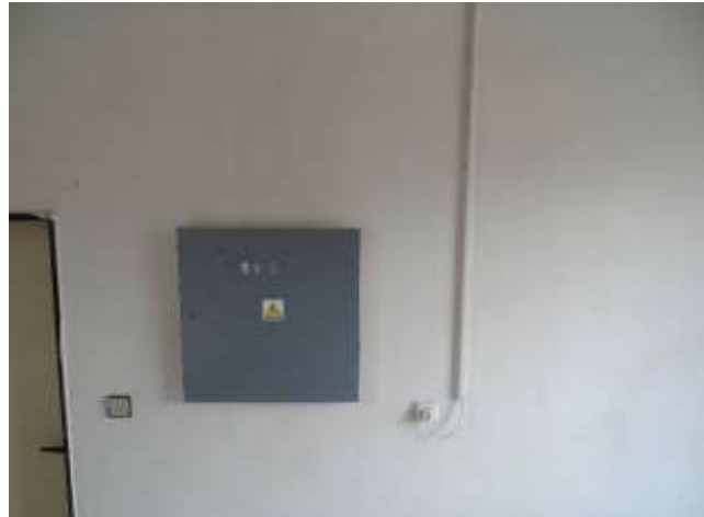
EST.2 – umístění stávajícího rozvaděče NN v technické místnosti.
