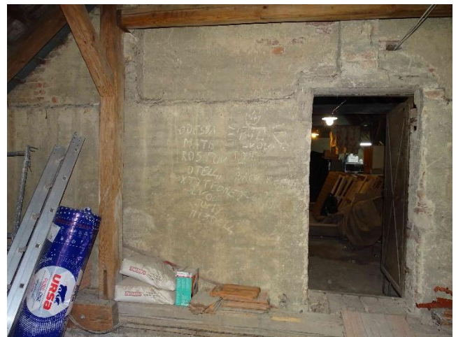
ESN.14 – místo pro nový rozvaděč sirény
