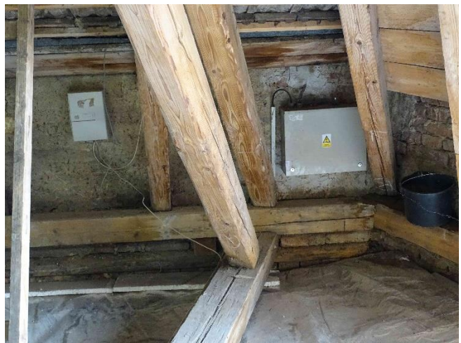
ESN.14 – umístění rozvaděče stávající sirény, podkrovním prostoru
