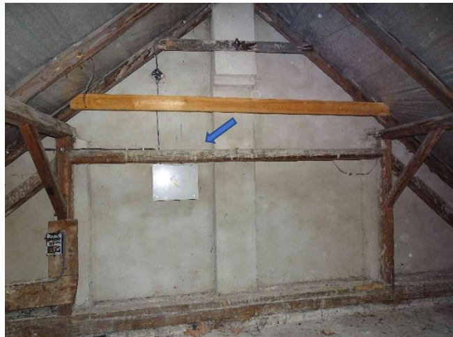
ESN.9 – umístění rozvaděče stávající sirény v podkrovním prostoru; vedle rozvaděče u sloupku bude instalován nový stožár
