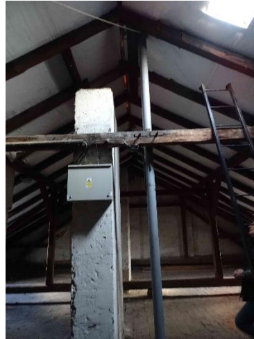
ESN.8 – umístění rozvaděče stávající sirény, v podkrovním prostoru
