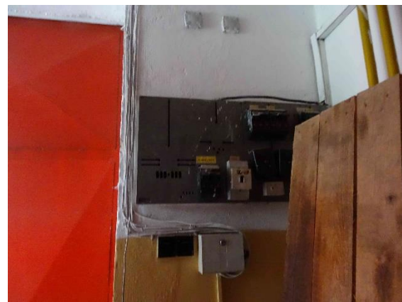
ESN.7 – stávající rozvaděč napájení
