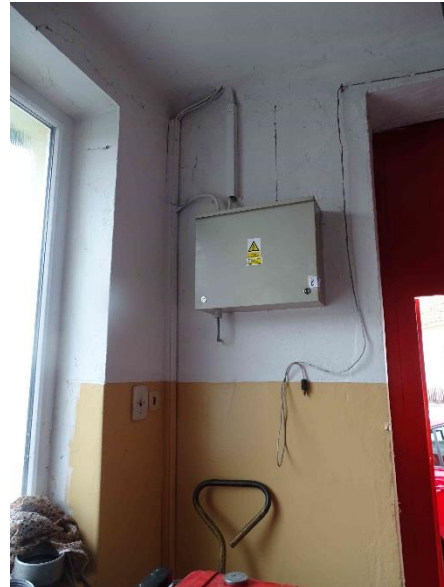
ESN.7 – umístění rozvaděče stávající sirény
