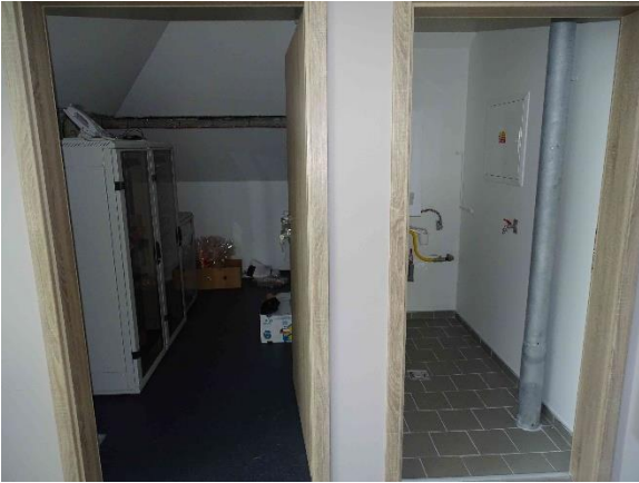
ESN.6 – stávající stožár sirény – umístění v kotelně vedle serverovny
