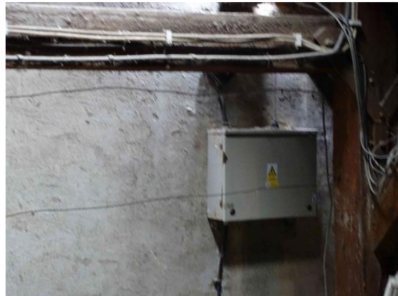
ESN.3 – umístění rozvaděče stávající sirény,
