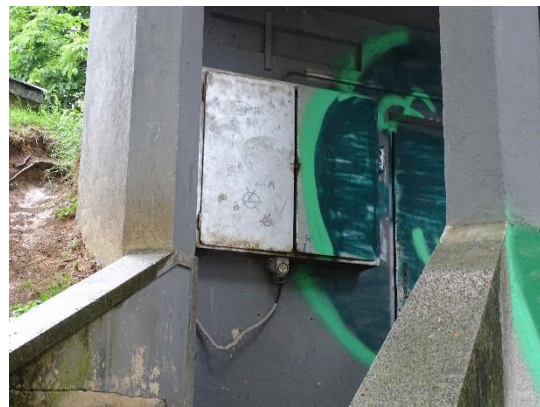
EST.17 – umístění stávajícího rozvaděče NN
