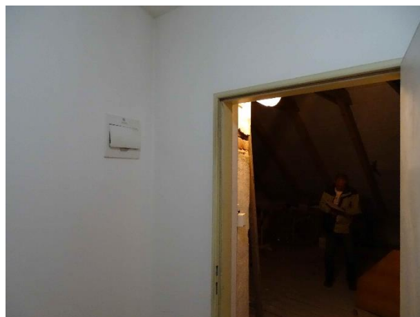
ESN.1 – stávající rozvaděč pro novou přípojku napájení nové sirény
