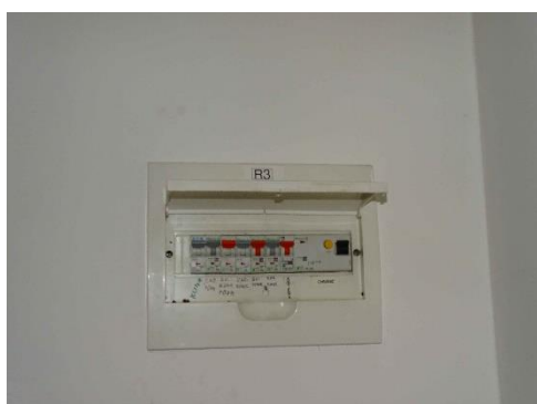
ESN.1 – stávající rozvaděč RS3, na volnou pozici bude doplněn jistič 10A/B pro nový rozvaděč OS sirény
