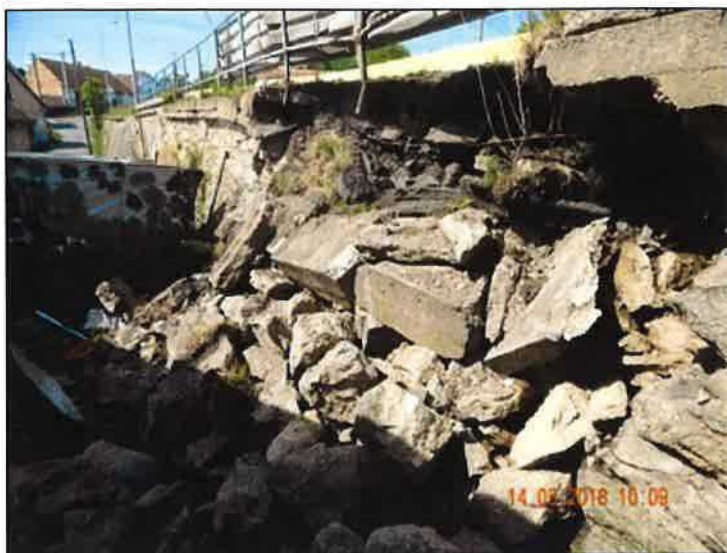
Pohled na navazující opěrnou zeď na pravé straně - část dále od mostu u které došlo k jejímu zřícení.
