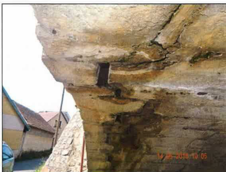
Detail otevřené spáry u klenáku v místě podélné trhliny na pravé straně.
