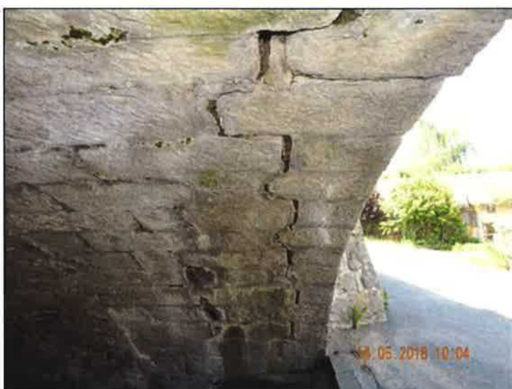
Podélná trhlina na levém kraji nosné konstrukce.
