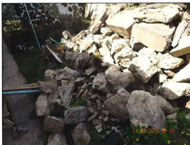
Pohled na navazující opěrnou zeď na pravé straně - část dále od mostu u které došlo k jejímu zřícení.
