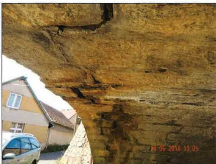
Podélná trhlina pravé straně nosné konstrukce.
