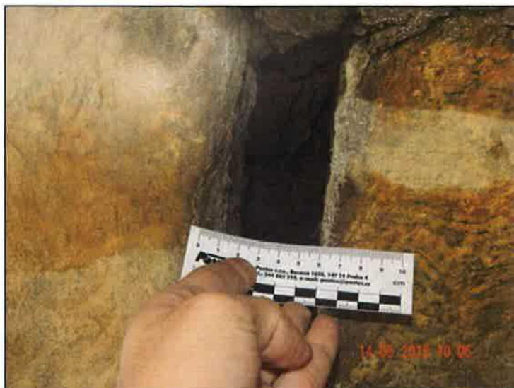
Detail trhliny na pravé straně šířky 50 mm.
