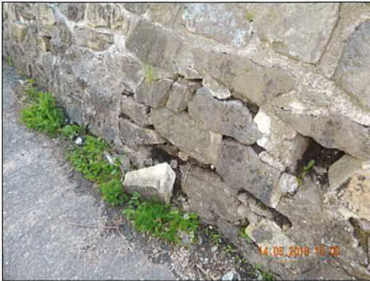
Pata navazující opěrné zdi na levé straně, vypadlý kámen.
