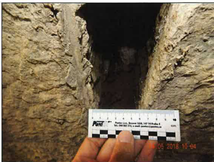
Detail trhliny na levé straně nosné konstrukce v úrovni rubu čelní zdi. Šířka trhliny 70 mm.
