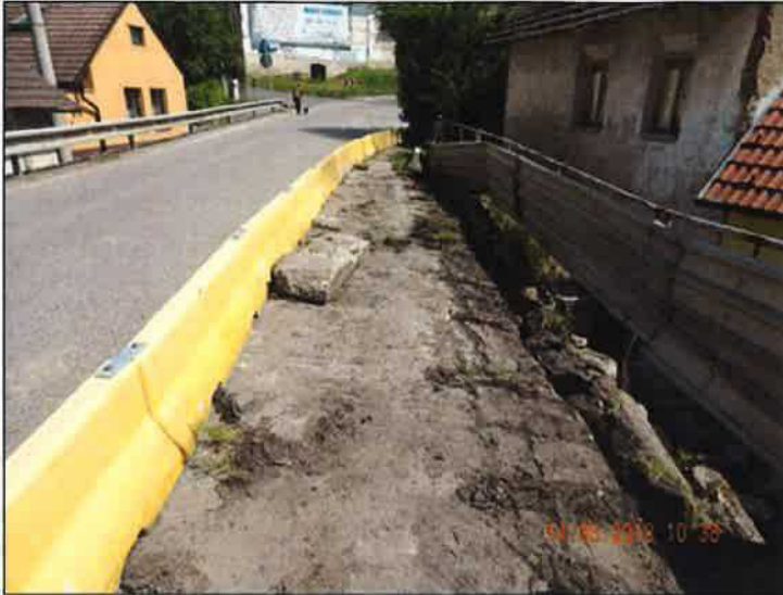
Deformace vozovky a podélné trhliny nad zřícenou částí zdi. Stav celého zemního tělesa je jen omezeně stabilní.
