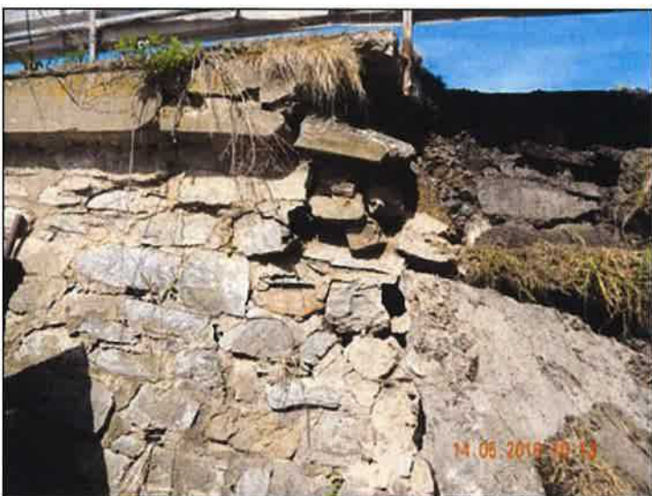
U části opěrné zdi navazující na zřícený úsek jsou v délce cca 2 m uvolněné kusy zdiva hrozí pádem pod zeď - nutné rozbrat uvolněné části zdiva.
