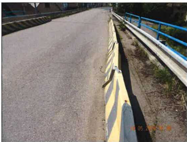
Deformace vozovky, podélné trhliny nad levou částí nosné konstrukce klenby - nutné zajistit aby vozidla nevjížděla na trhlinami porušenou část vozovky.
