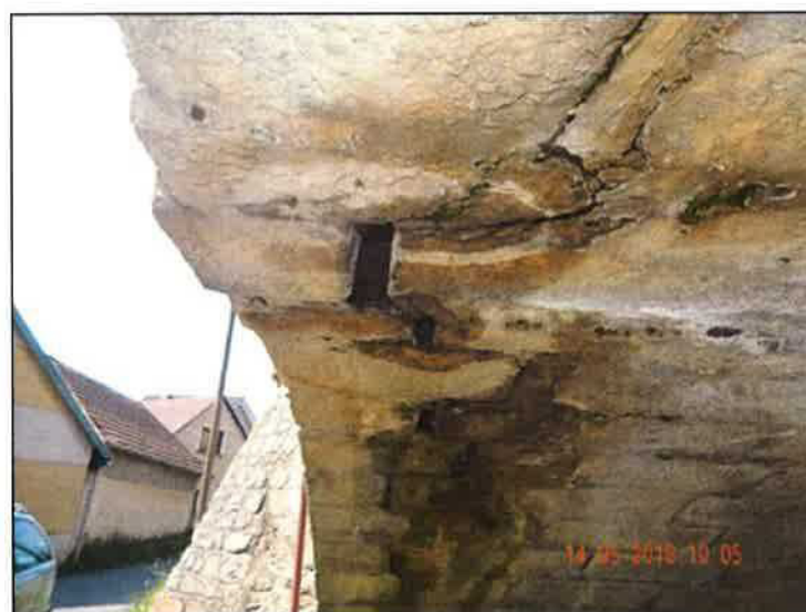
Detail otevřené spáry u klenáku v místě podélné trhliny na pravé straně.
