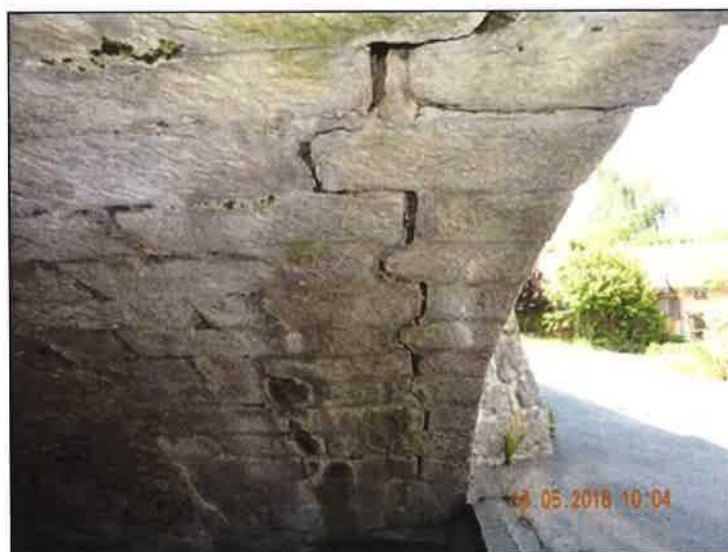
Podélná trhlina na levém kraji nosné konstrukce.
