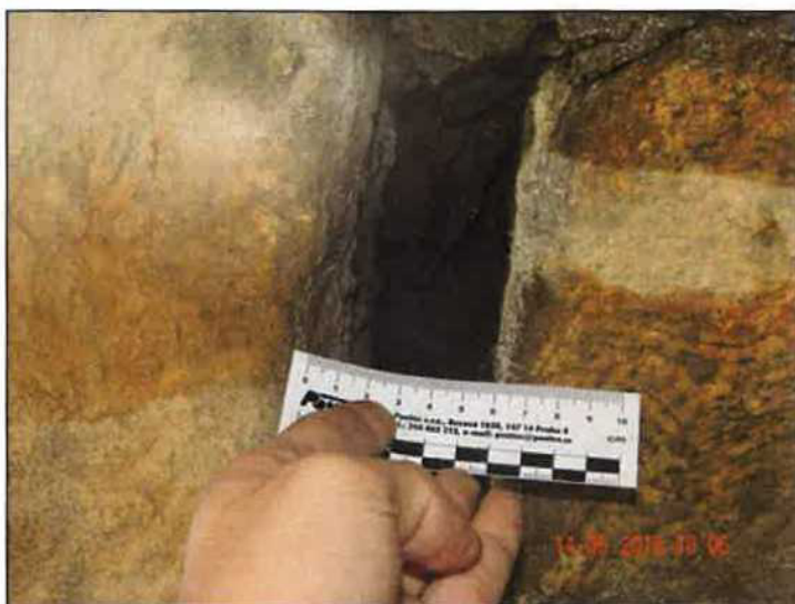
Detail trhliny na pravé straně šířky 50 mm.
