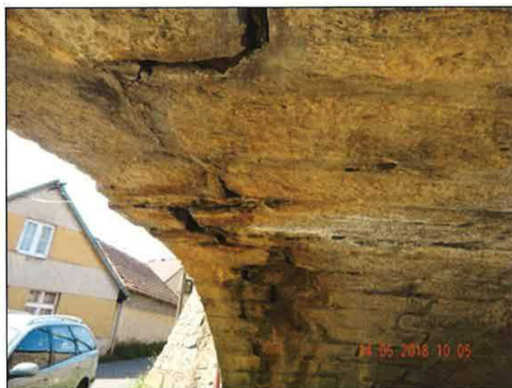
Podélná trhlina pravé straně nosné konstrukce.
