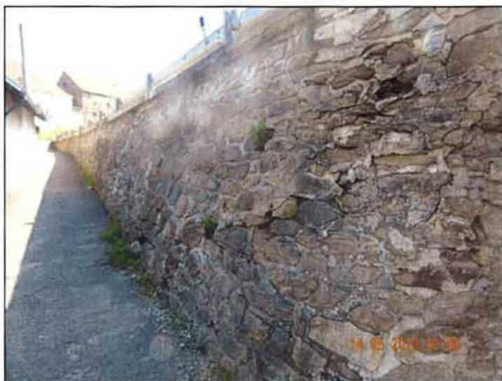
Pohled na navazující čelní zeď na levé straně, plošně vypadlé spárování, místa rozvolněné kameny, uchycená vegetace.
