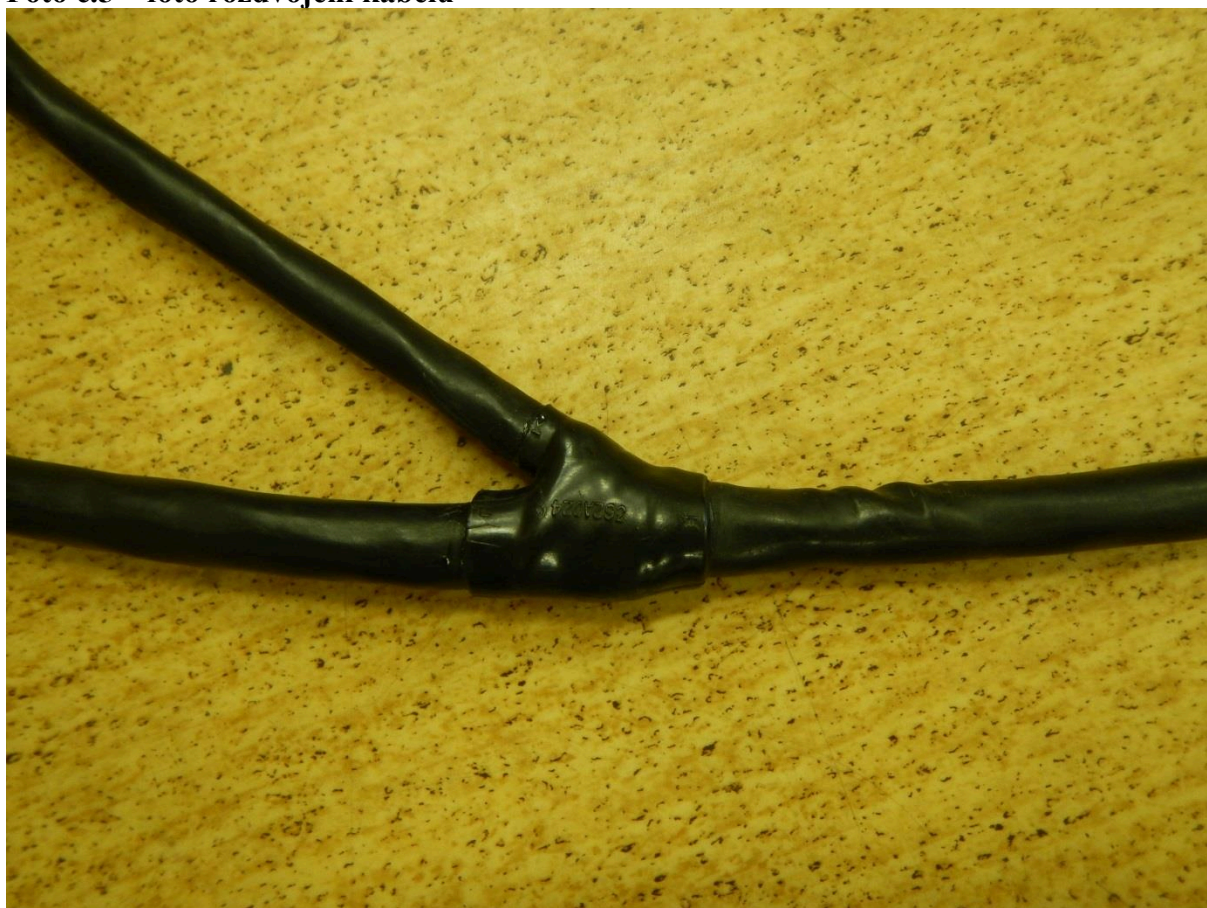
Foto č.5 – foto rozdvojení kabelu
