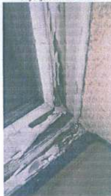
Destrukce dřevní hmoty oken
