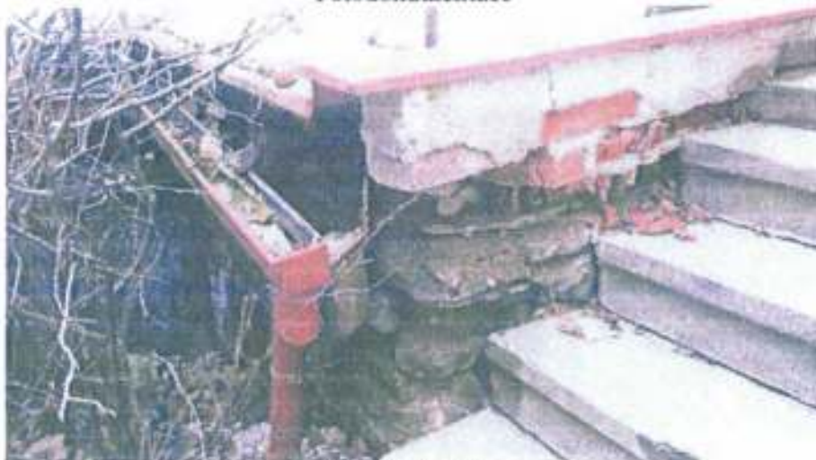
Rozpadající se zdivo
