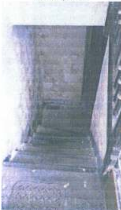
schodiště do sklepa a vlhkost zdiva
