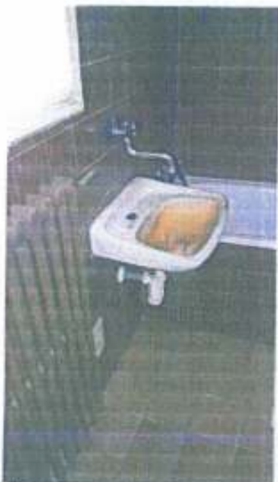
Zničené umyvadlo z protékající vody
