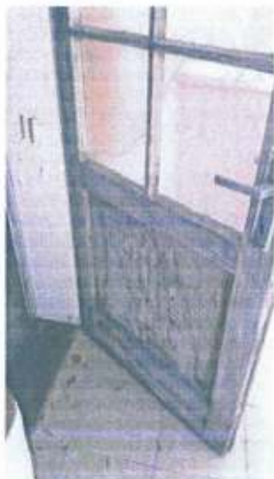
Chybějící nátěry dveří
