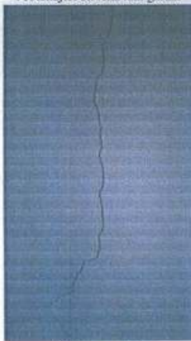
Trhliny ve zdivu
