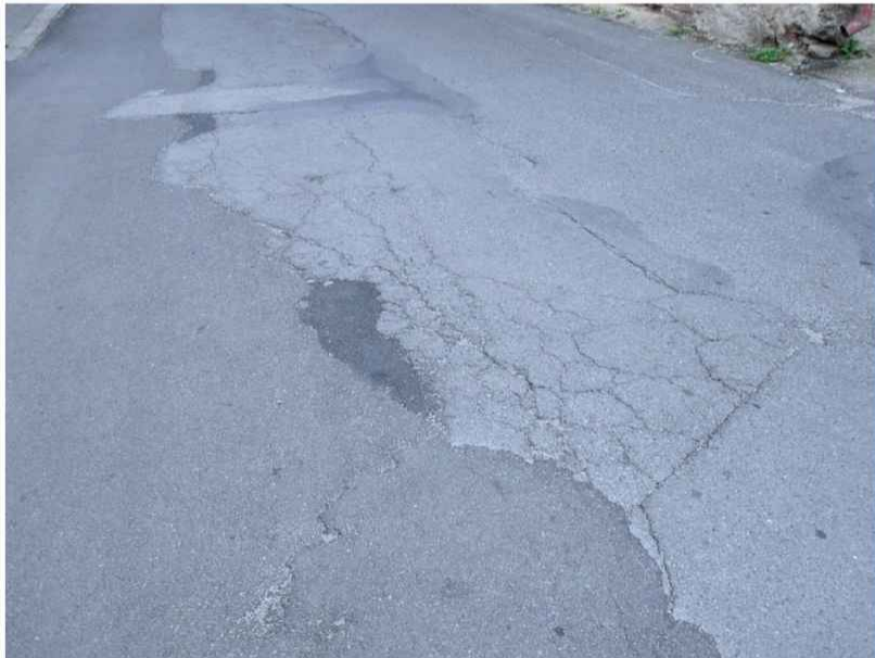
Deformace, síťové trhliny, vysprávkky
