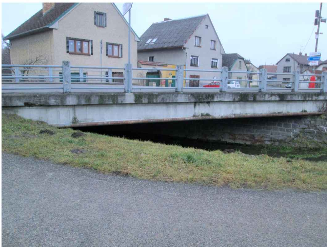
Most 12137-1, pravá strana, vady na římse a opěře
