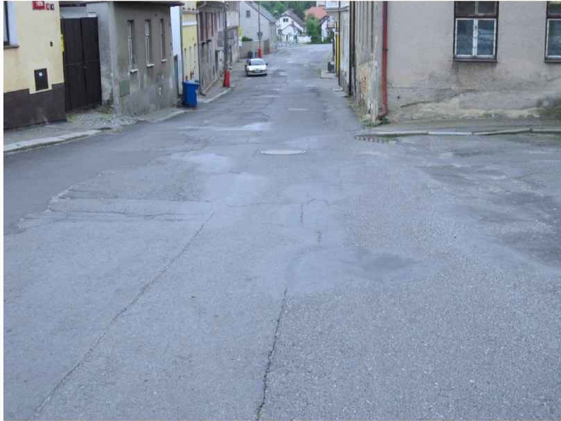
Pohled po staničení, trhliny, deformace, vysprávkky
