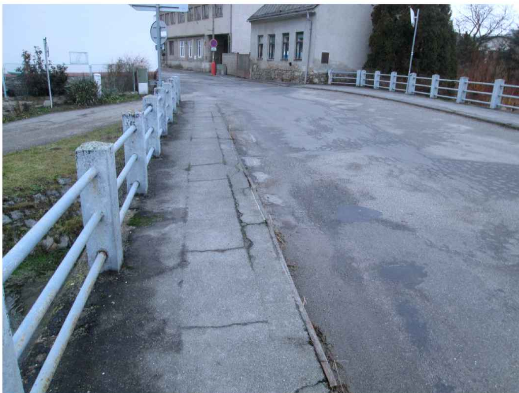
Most 12137-1, destrukce vozovky
