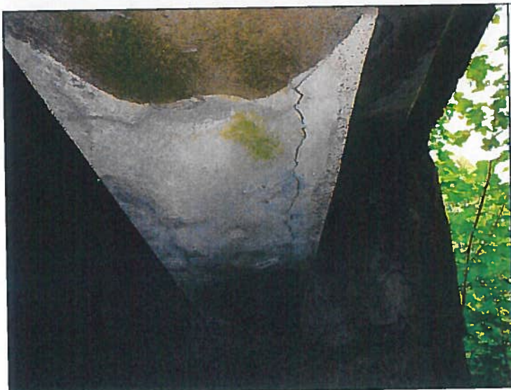
Trhliny a stopy po zatékání na krajní trám konstrukce.
