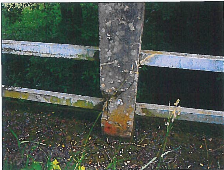
Trhliny v bet. sloupcích zábradlí
