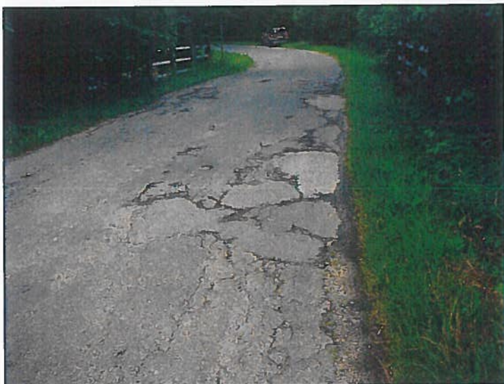
Trhliny a výtluky ve vozovce
