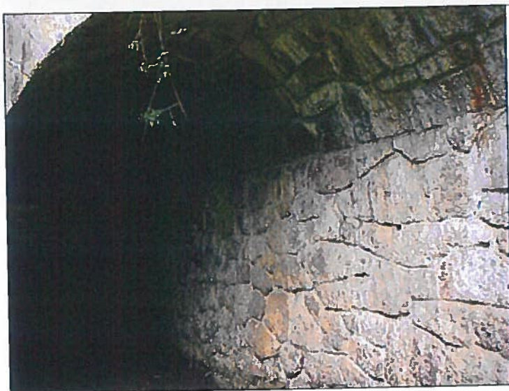
zatékání na pravé straně NK
