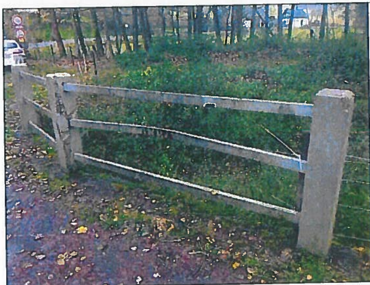
Poruchy zábradlí na vtokové římse
