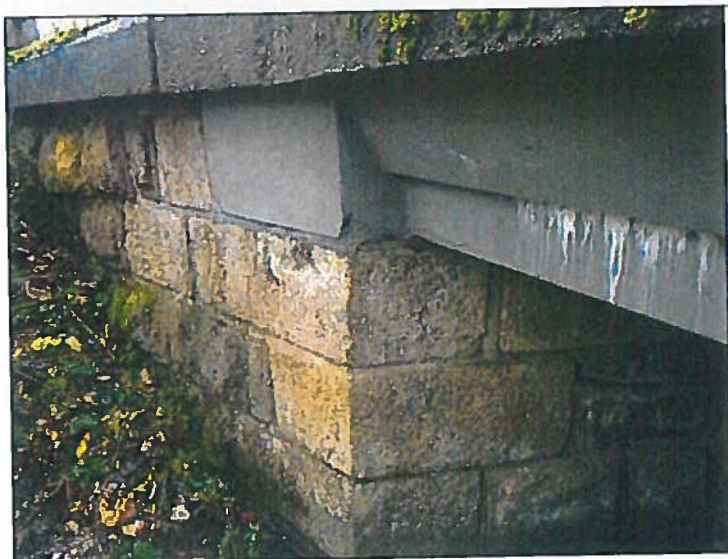
Poruchy NK na vtokovém čele
