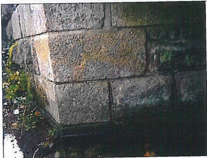
Poruchy spárování na opěrách v krajních oblastech
