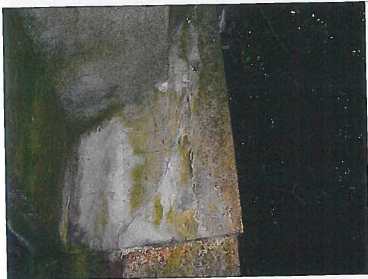
Trhliny na krajích koncových příčníků
