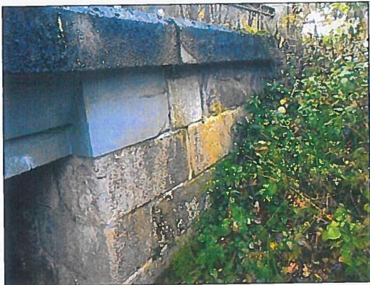
Poruchy NK na vtokovém čele
