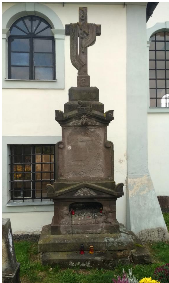
Foto1 Preislerův kříž, celek, degradované povrchy, chybějící schodový stupeň, výklenek s božím hrobem zalitý voskem ze svíček.
