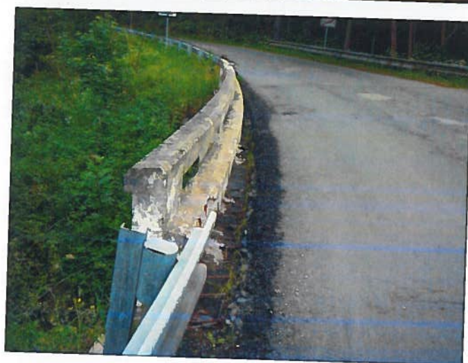
Rozpad odvodnění na levé straně konstrukce
