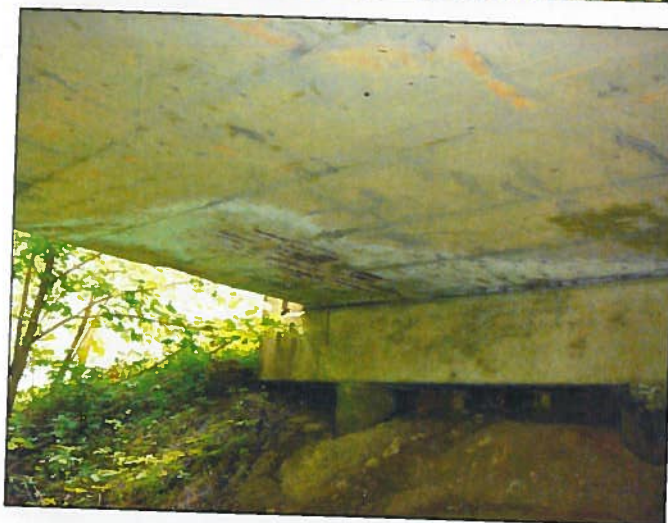
Obnažená výztuž NK silná koroze výztuže
