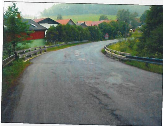
Pohled proti směru staničení, trhliny a výtluky ve vozovce
