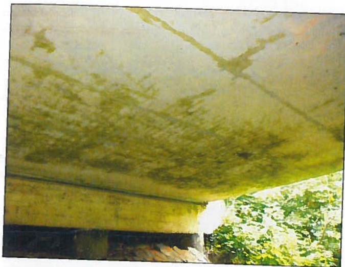
Podhled NK stopy po zatékání
