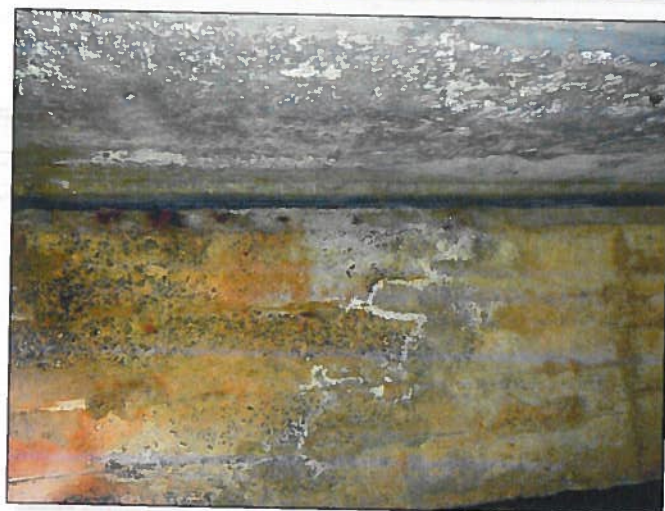
Degradace betonu UP u obou opěr
