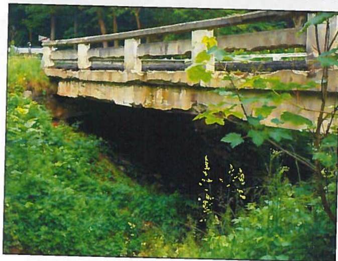
Pohled na levou stranu konstrukce, rozpad betonu římsy a NK
