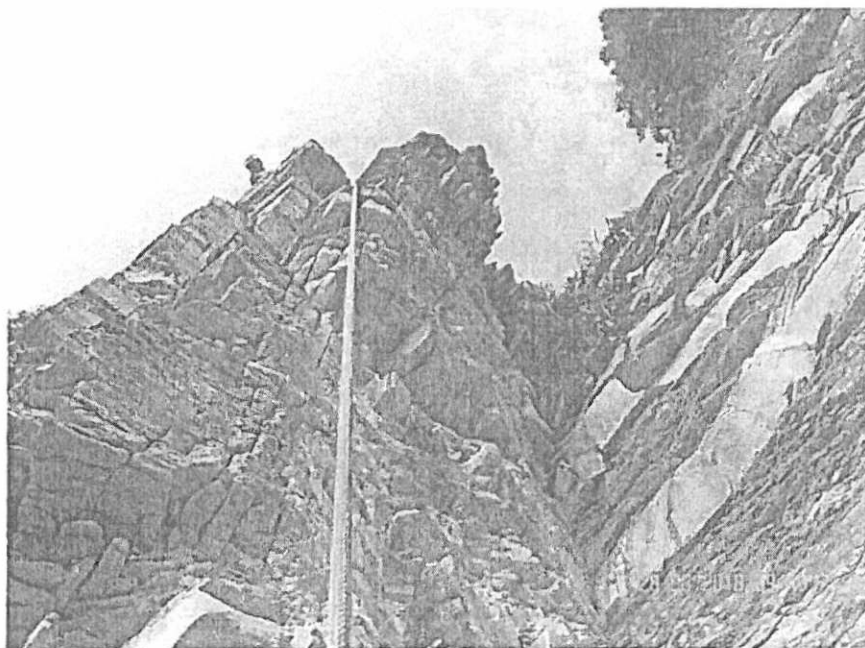
Fotografie 4: převislé partie ve skalní stěně.
