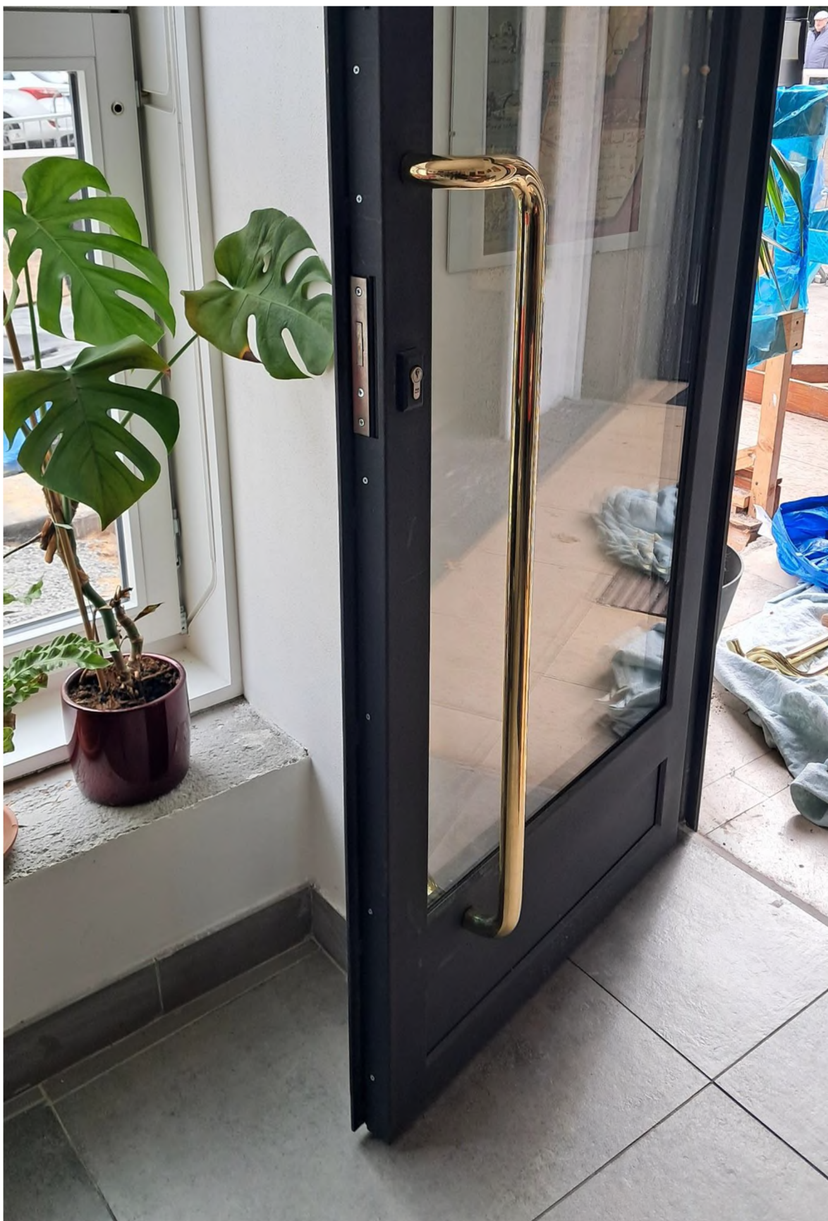
Namontováno na dveřích.
