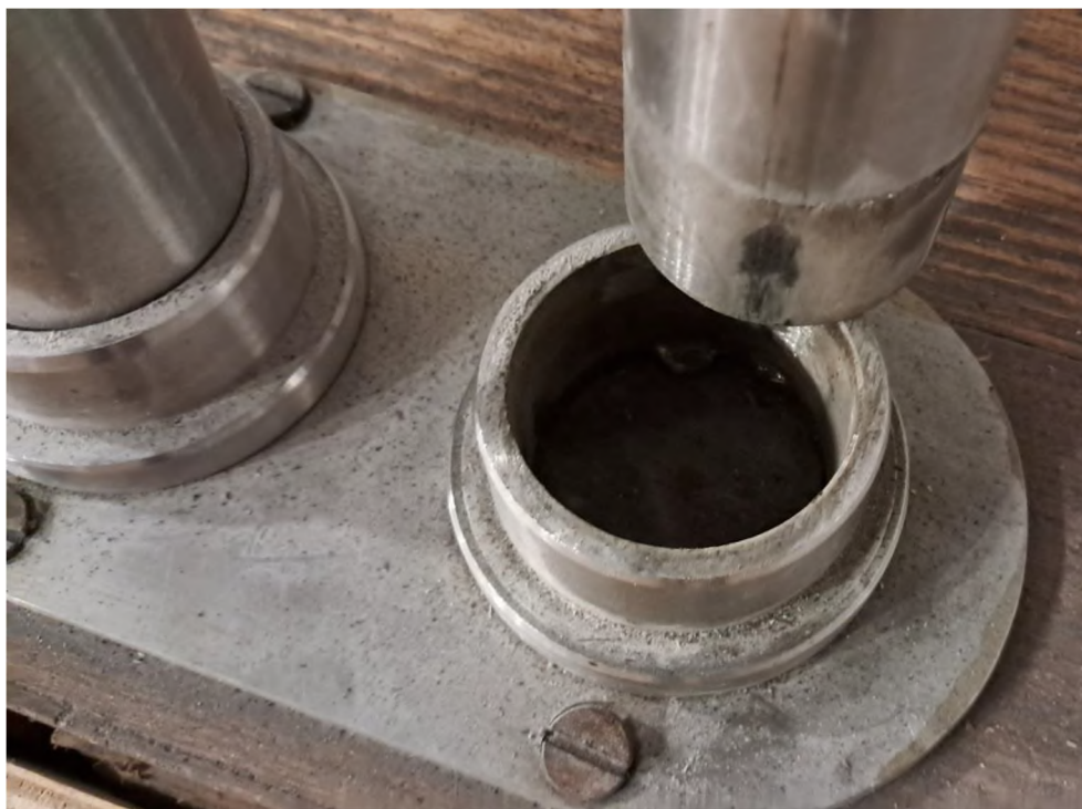
Pohled na vyjmutou trubku z příruby + nevhodné upevňovací vruty základny.
