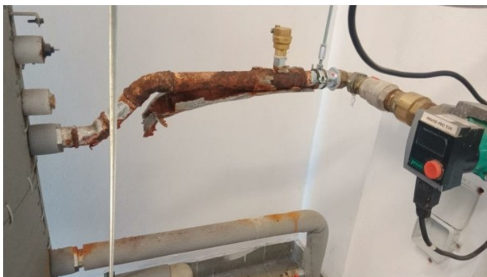
Zrezlé potrubí ohřevu teplé vody
