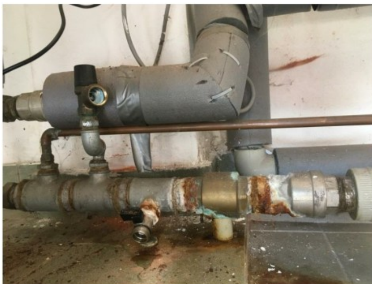
Zrezlé potrubí studené vody
