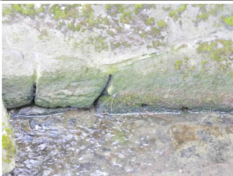
Křídlo O 02 vlevo: Spárování zdiva v dolní části jednotlivě vyplavené
