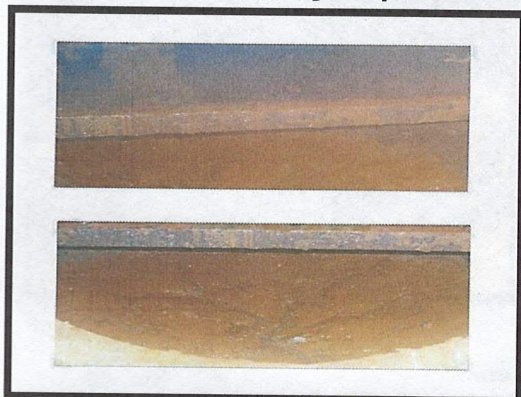
Rozpuštěný kámen v bojleru po čištění:
