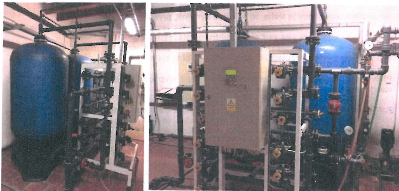
Stávající písková filtrace
