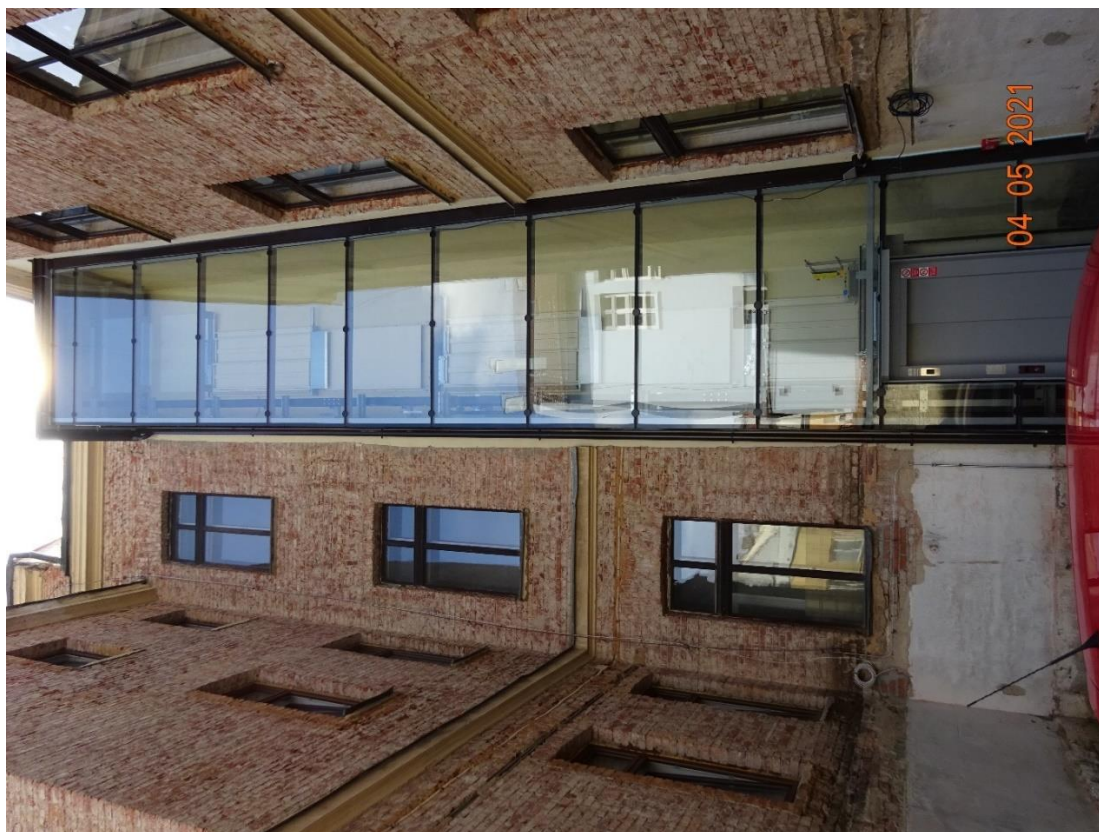
Obr. 3 – Pohled A: roh jižního a západního křídla, kde jsou patrné zbytky původních garáží, kde byl v roce 2019 přistavěn osobní venkovní výtah, tři dvojité okna (ozn. 33) z chodby určená k výměně
