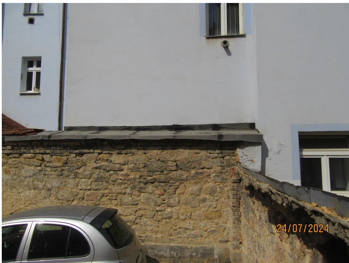
Obr. 66 – chybějící oplechování na opěrné zídce OZ1, které bylo součástí odstraněných garáží
