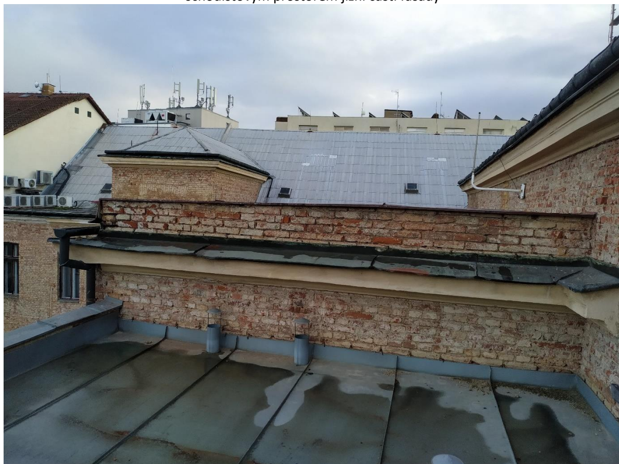
Obr. 22 – Pohled A: chybějící omítka na části jižní fasády v úrovni půdního prostoru
