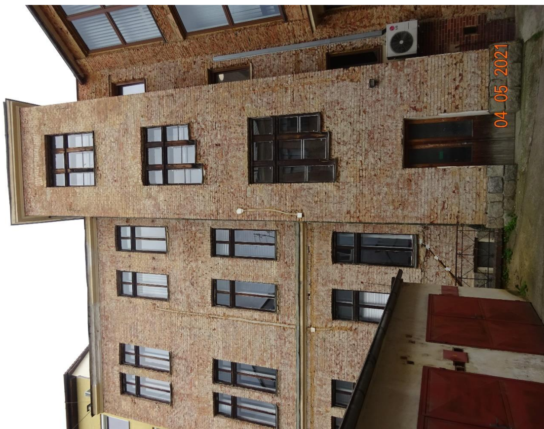
Obr. 33 – Pohled D: fasáda východního křídla, pohled na tři dvojité schodišťová okna (ozn. 13 a 2x14) určená k výměně, v přízemí částečně prosklené dvoukřídlé dřevěné dveře (ozn. 204) určené k výměně, vpravo pohled na již vyměněná jednoduchá jednokřídlá dřevěná okna (ozn. 1) na soc. zázemích (WC muži)
